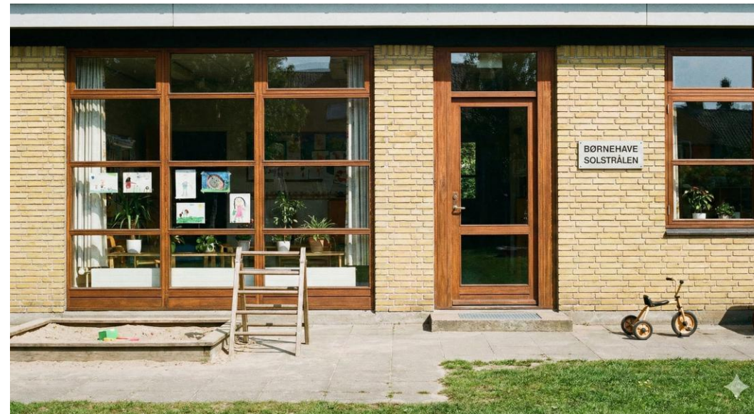
Illustration: Facaden på børnehaven er velholdt, og vinduerne udskiftet
